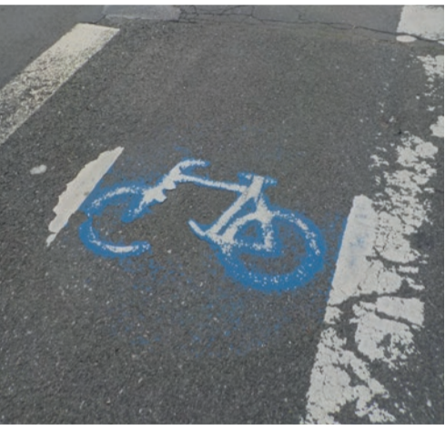
Radstreifen auf der Frankenstraße: Markierungen sind kaum noch zu sehen
